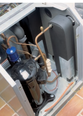
Innenleben einer Sole-Wasser-Wärmepumpe mit Kompressor
